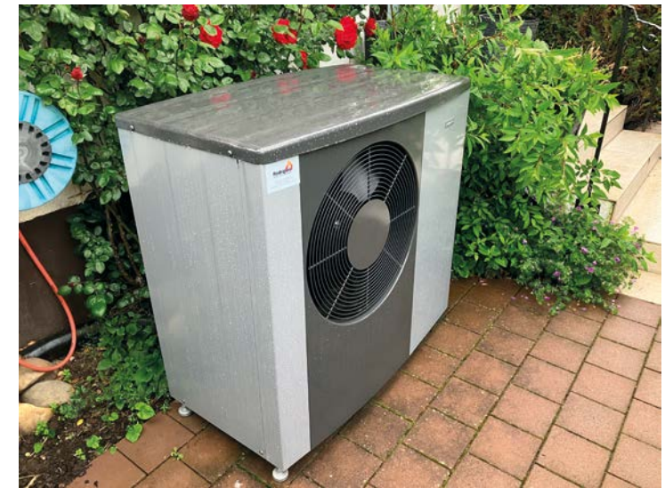
Auch bei diesem Anblick auf die sauber montierte Wärmepumpen-Infrastruktur bleiben keine Wünsche offen.
